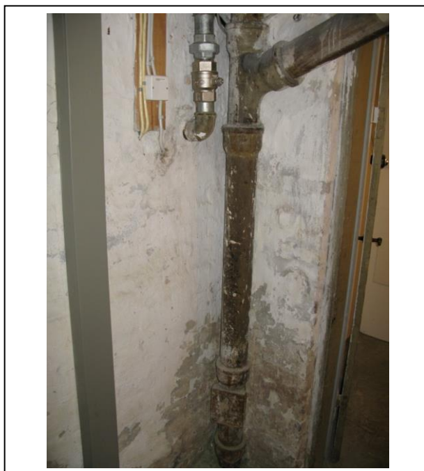
Eksempel på eksisterende faldstamme for WC-rum i kælder
