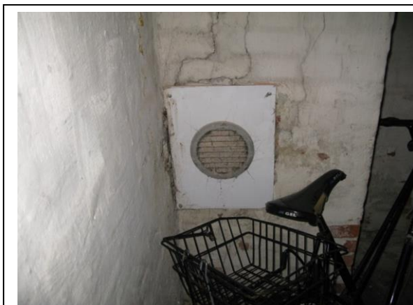
Eksempel på rist i kældere, i skorsten
