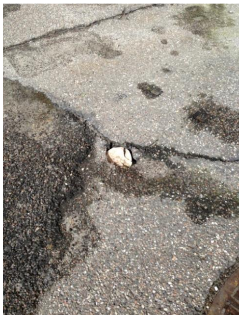
Underminering, "rottehul" (Blokeret med sten)
