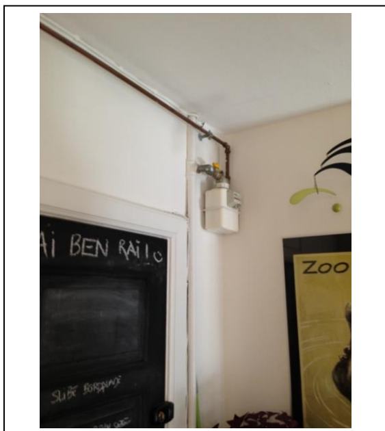
Lodret føring, gasmåler og tilslutningsledning
