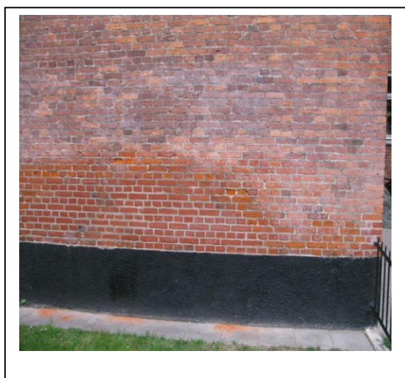
Facade, gård 2 – ødelagte sten og fuger
