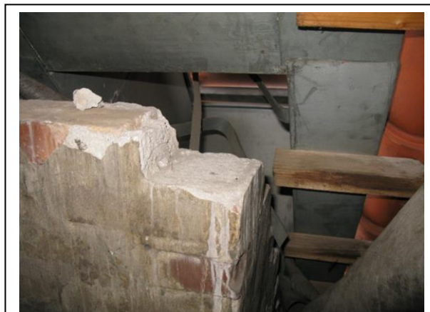
Eksempel på kanaler der ikke er ført til taghætte
