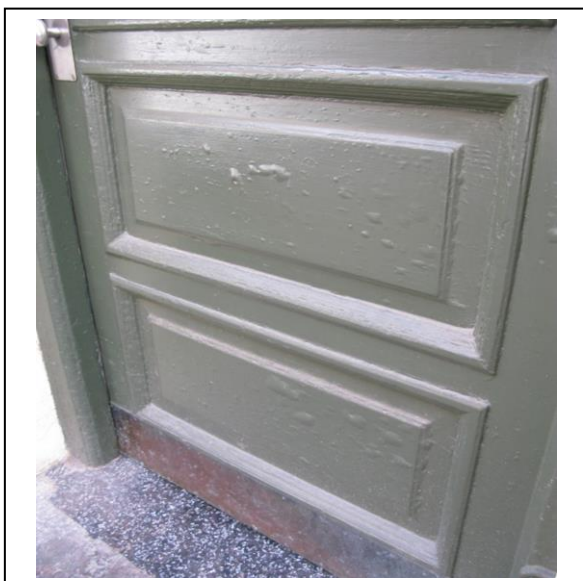
Hoveddør med luftblærer under maling
