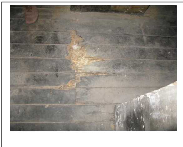
Gulv ved opgang 24C
