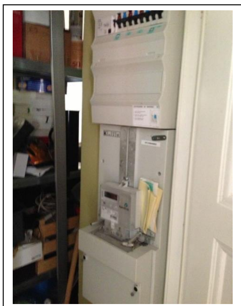
Eksempel på nyere installation
