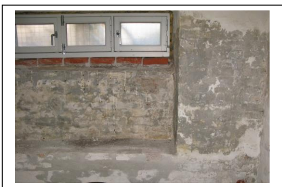
Fugt på vægge
