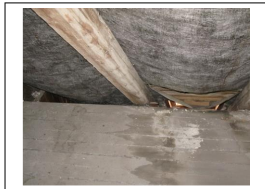
Tagdug ikke monteret korrekt
